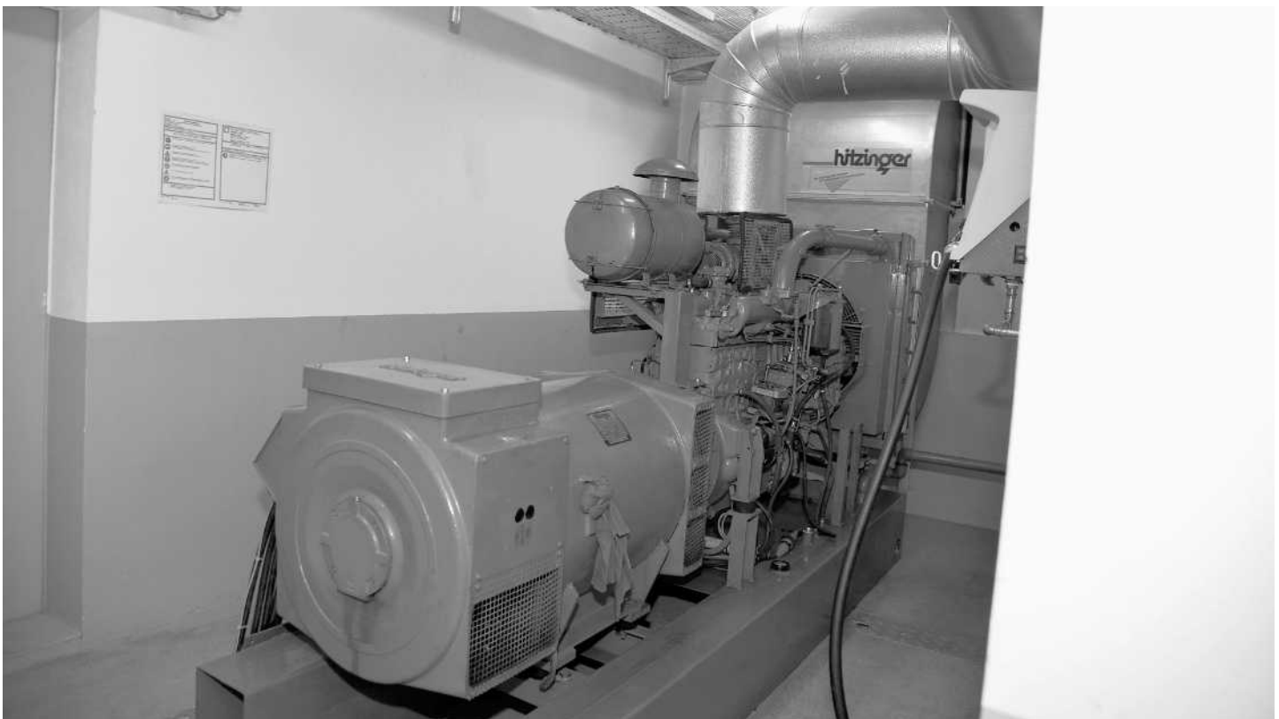
Das Notstrom-Aggregat im Rathaus hat perfekt funktioniert.
