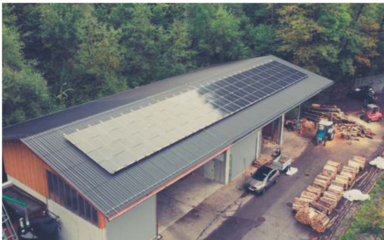
SONNENKRAFTWERK BEIM FORSTGEBÄUDE ENZ
