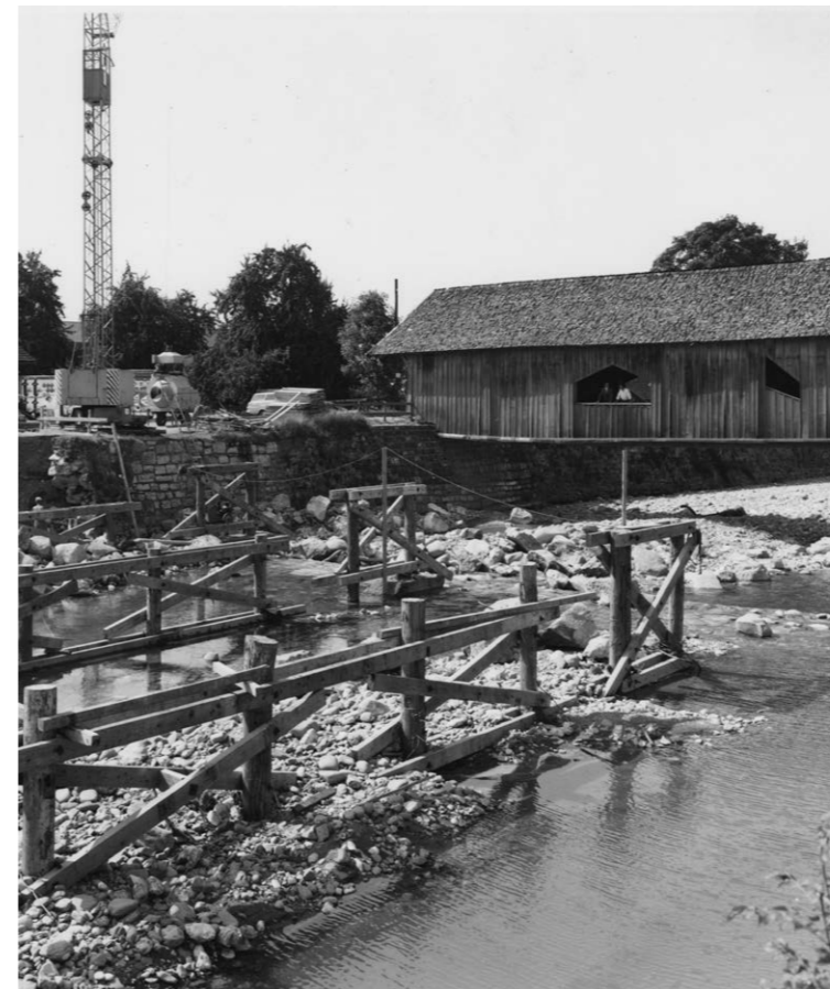
Beginn der Bauarbeiten an der neuen Schmelzhütterbrücke 1964. Aufnahme von Foto Rhomberg | Foto: Stadtarchiv, Sign. 59959
