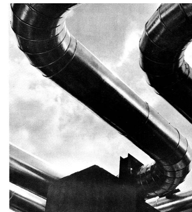
Dehnungsbogen der Fernheizleitung Fischbach-Steinebach | Foto: Franz Beer
